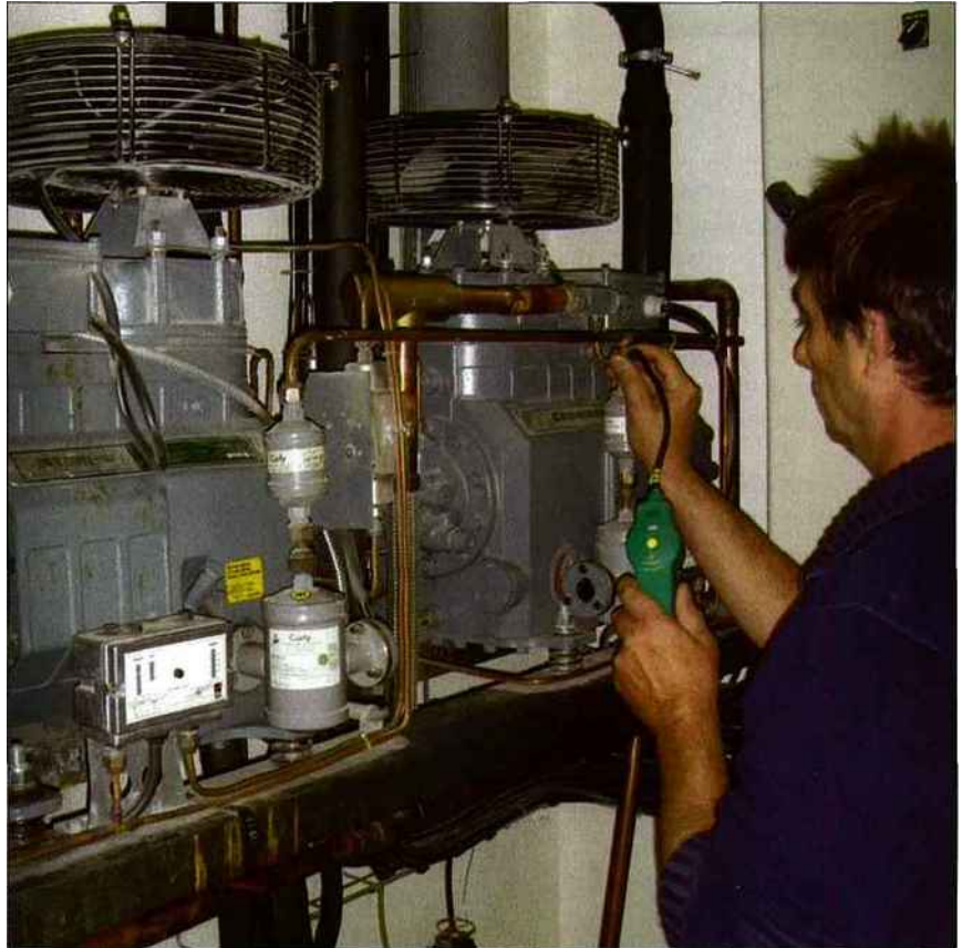
Le confinement des fluides frigorigènes dans les équipements de froid ou de climatisation est soumis à de nouvelles règles. Tous les professionnels, des producteurs de fluides aux opérateurs intervenant sur ces installations, sont concernés.
